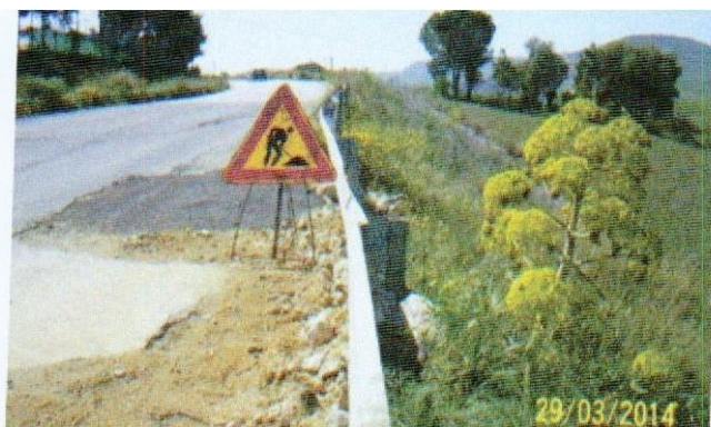
S.P. n°23 bis Regalbuto/Catenanuova – KM 10+100 – Particolare dissesto
