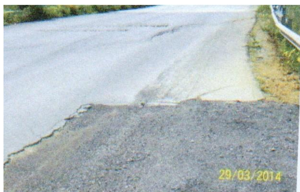
S.P. n°23 bis Regalbuto/Catenanuova – KM 10+100 – Particolare dissesto
