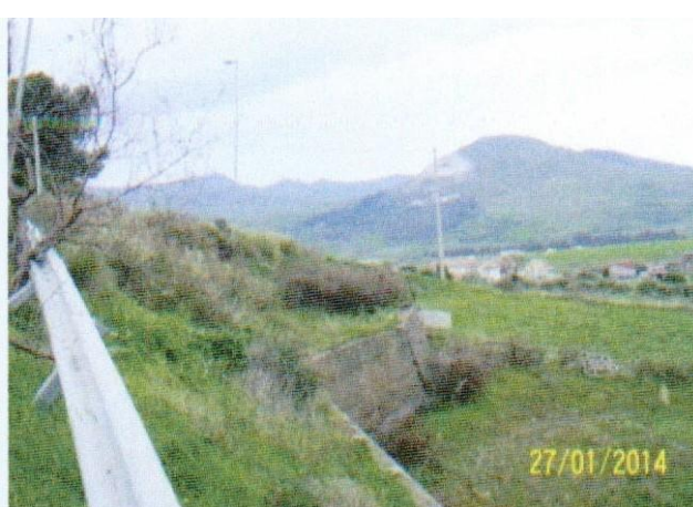
Porzione scorrimento della scarpata stradale e muro di contenimento
