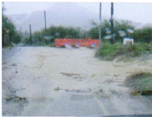
Superamento e allagamento sede stradale sovrastante
