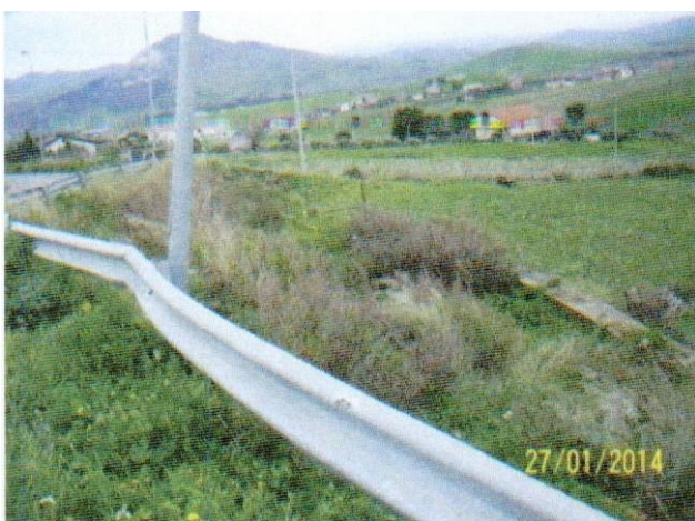
Porzione scorrimento della scarpata stradale
