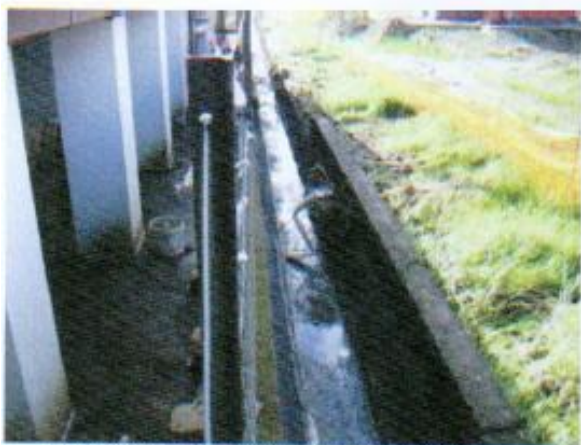
Danni ai fabbricati – Eventi alluvionali gennaio 2009
