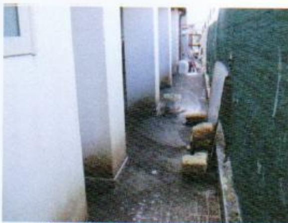
Danni ai fabbricati – Eventi alluvionali gennaio 2009
