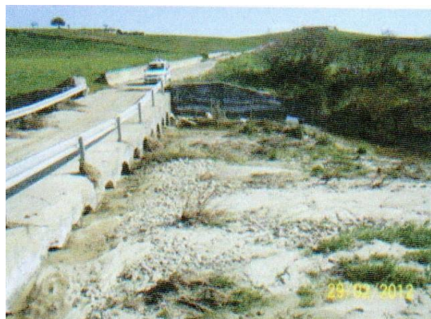
Stato di fatto dopo gli eventi alluvionali per febbraio 2012
